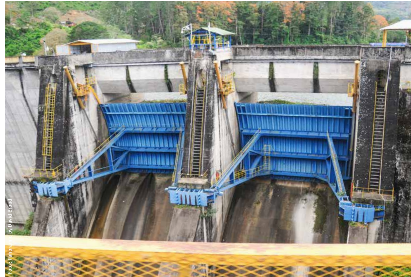
Hoy en día, la planta hidroeléctrica Cachí cuenta con la capacidad para generar casi 160 MW, gracias a las labores de expansión que se llevaron a cabo.
