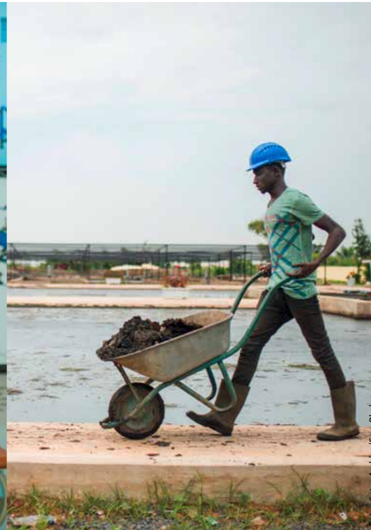
Los residuos se transportan al Omni Processor para su tratamiento.
